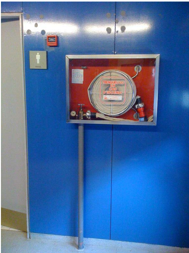
Fotografia exemple de situació de BIE existent, s,ha de canviar de lloc.
