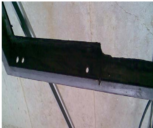
Forats de cargols, part inferior del bastiment.
